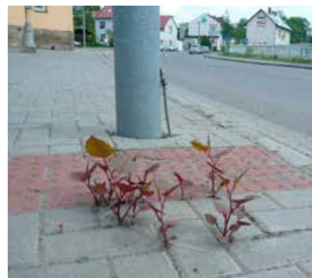
Křídlatka je schopná prorůst novým asfaltem nebo rozebrat zámkovou dlažbu
