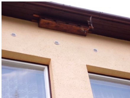
Při zateplování budov, které v posledních letech probíhá masovým způsobem, jsou větrací otvory zakrývány bílými kruhovými krytkami. Je to zdůvodňováno estetizací objektů a zamezením vnikání nežádoucích živočichů (vosy apod.)
